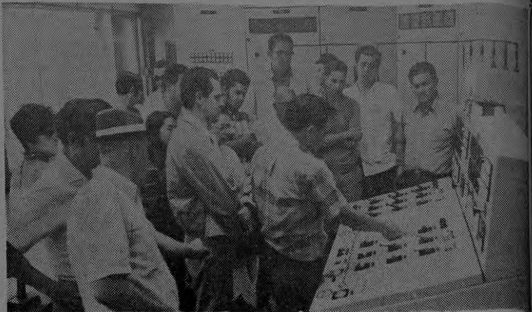
Este es el panel de instrumentos de control del Río Macho, la primera planta del ICE que entró en operación después de La Garita. Luego vino Cachí, y ahora, en construcción, Ta-
